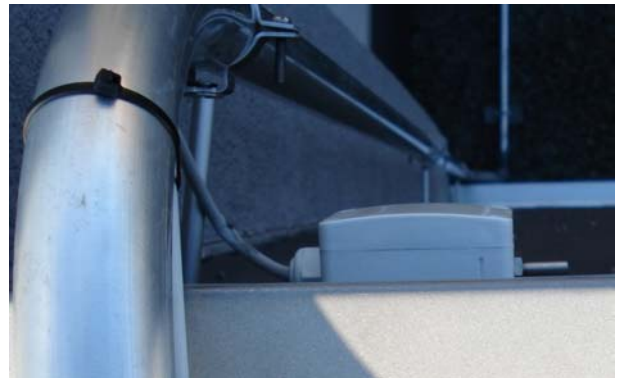
Figur 5: Messwandler auf dem Dach
