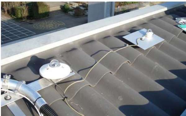
Figur 4: Pyranometer horizontal und in Modulebene
