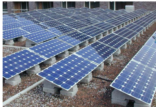
Abb. 5: SOFREL Anlage auf Haus B2
