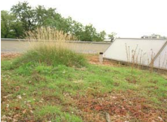
Abb. 46: Kleine Substrathügel erhöhen die Artenvielfalt auf dem Dach, hier bei der Altersresidenz Schwarzpark
