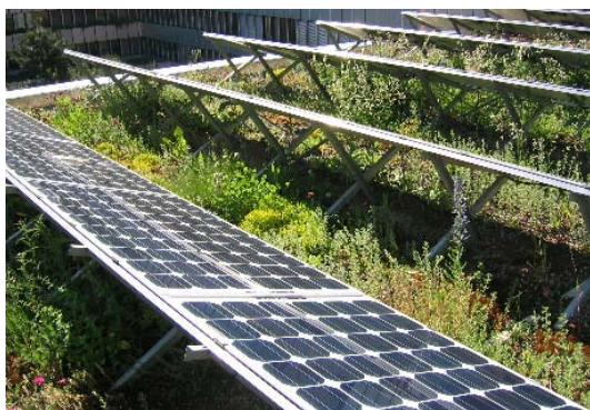
Abb. 4: Solgreen Anlage auf Haus B3
