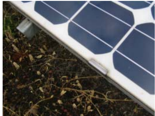
Abb. 30: leichte Schmutzablagerung an der Befestigungsklammer Unterkonstruktion mit Dehnungsmessstreifen
