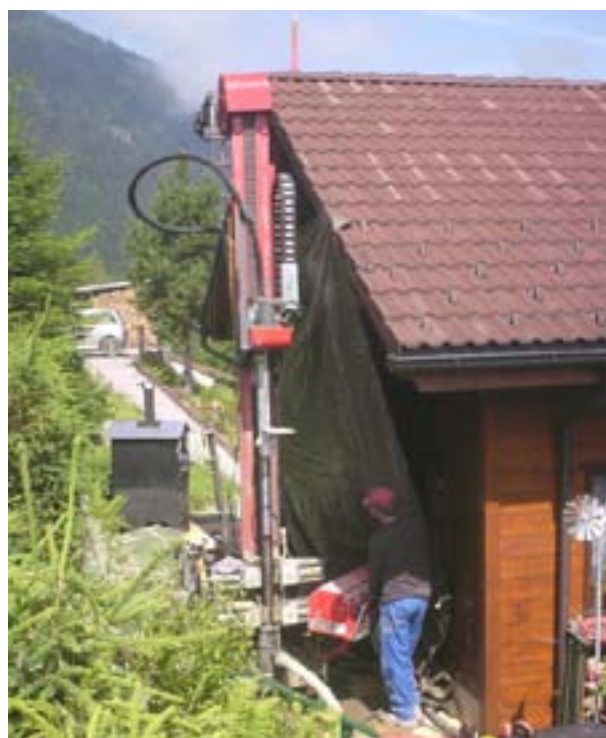
Figur 3: Das Bohrgerät Terradrill kann bei engen Platzverhältnissen eingesetzt werden. (Quelle: Terra AG)
