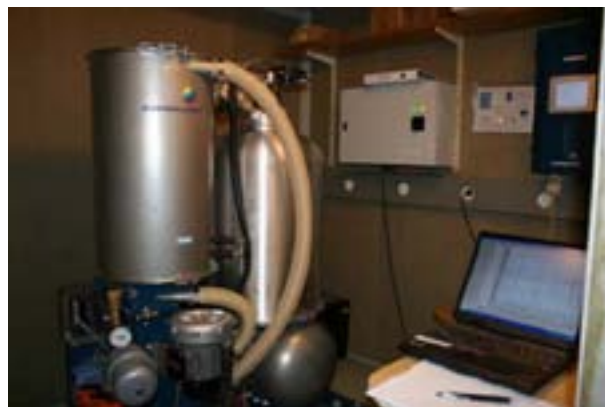
Figur 5: Am Ökozentrum Langenbruck installierte Biomasse-Wärme-Kraft-Anlage mit Messdatenerfassung (Bild: Ökozentrum Langenbruck)
