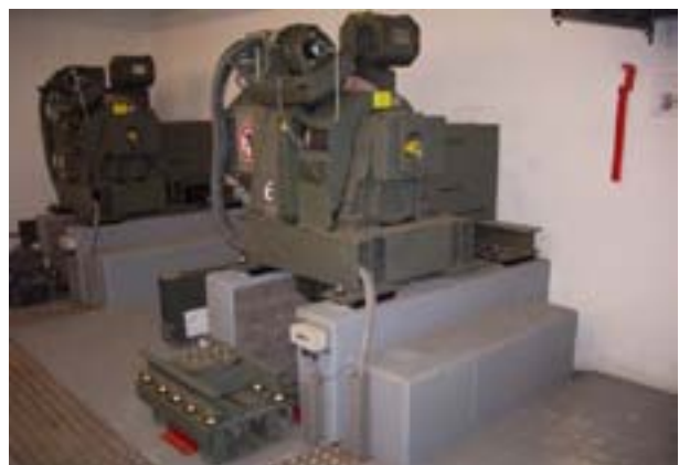
Figur 5: Liftdriveeinheit, die ausgemessen und mit dem Prototypen ausgestattet wird (Quelle: Schindler).
