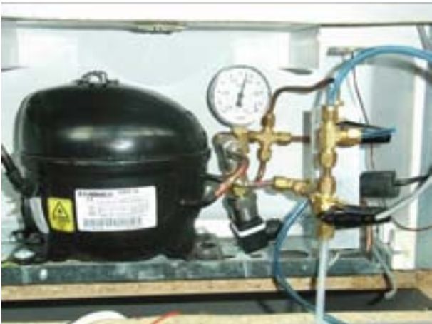
Figur 6: Installierter drehzahlvariabler Kompressor (Quelle: awtec).
