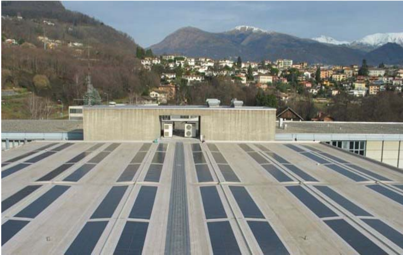
CPT – Centro Professionale di Trevano, 2003, 15,4 kWp
