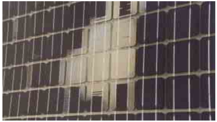
Delamination eines Moduls Ursache: z.B. Unverträglichkeit Zell- und Verbundmaterial
